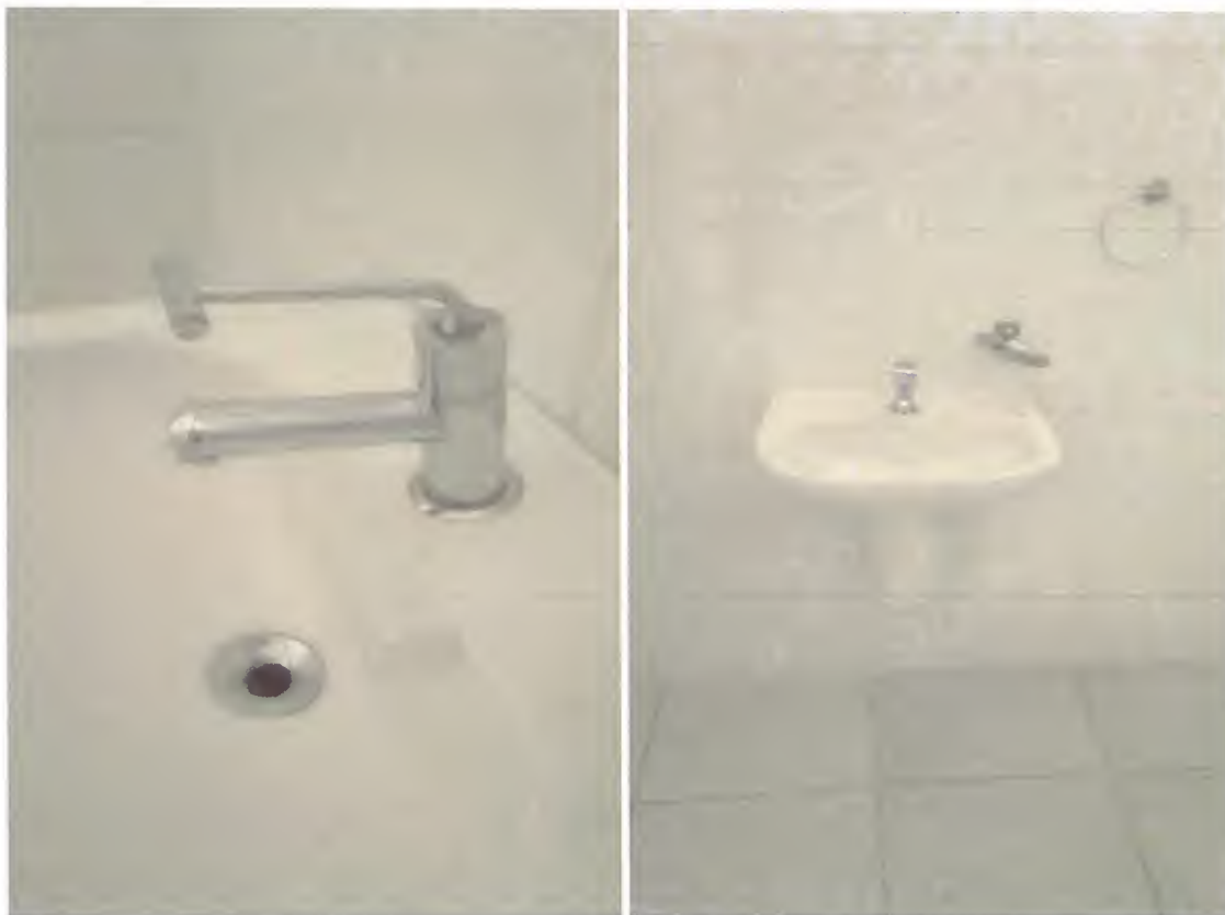
Lavatórios suspensos e com torneiras de alavancas conforme Norma Técnica
