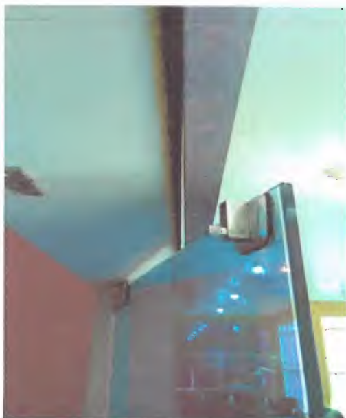
A porta ao abrir para foyer é impedida por um quadro instalado na entrada do auditório.
